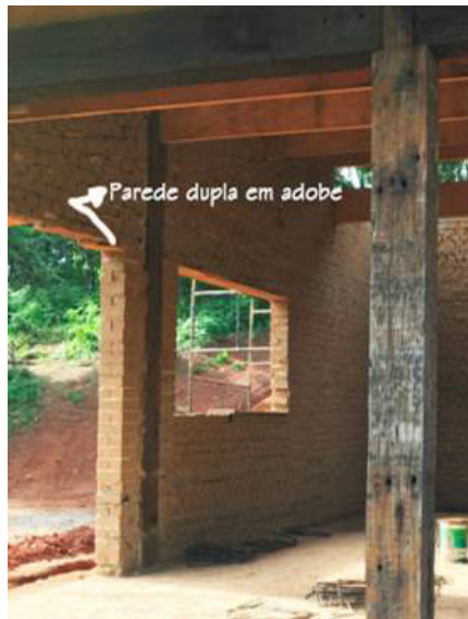
Figura 7 - Duplicidade do adobe na parede externa na edificação unifamiliar (crédito: M Marques, 2017)
