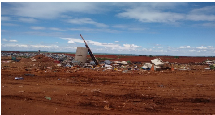
Figura 3 – Resíduos de Construção Civil dispostos de forma inadequada no maciço de resíduos.
