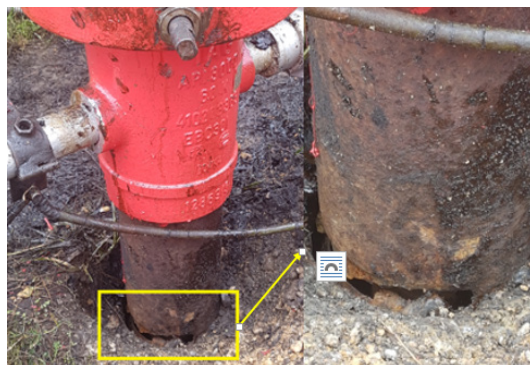
Figura 3: Revestimento de produção rasgado por corrosão
