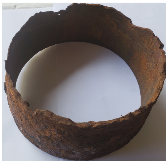
Figura 4: Amostra do ponto do revestimento que falhou
