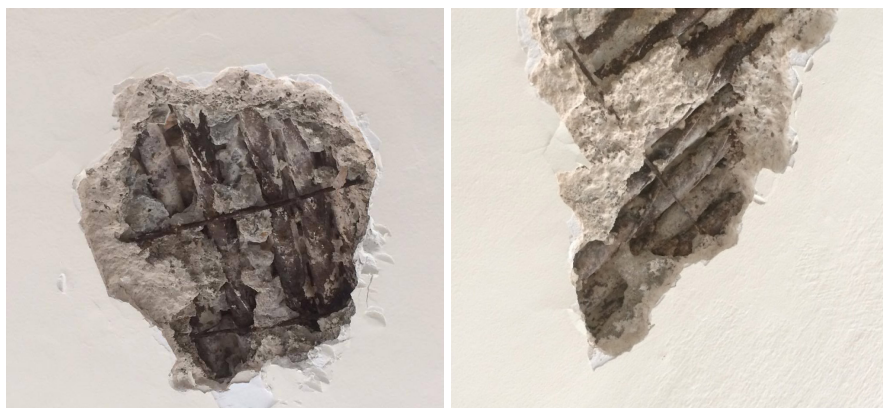
Figura 8 – Ausência de cobrimento
