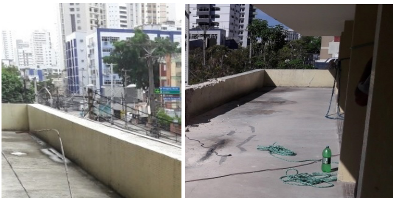
Figura 9 – Manchas de umidade provenientes do acúmulo de água
