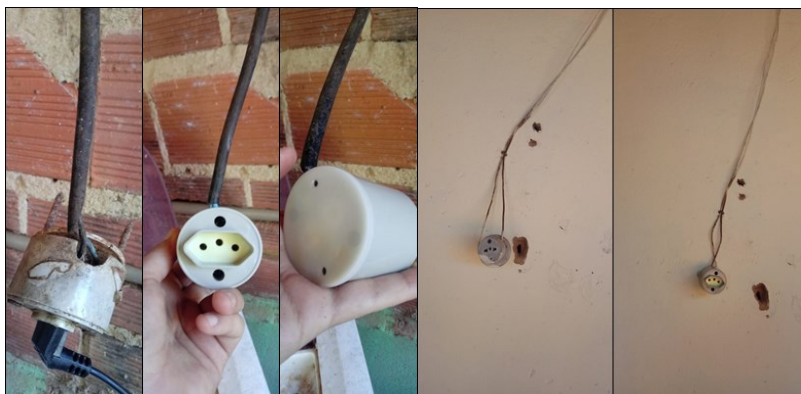
Figs. 12 e 13: Troca de tomadas com fios aparentes e de modelo antigo, diminuindo significativamente o risco de choques por contato direto.
