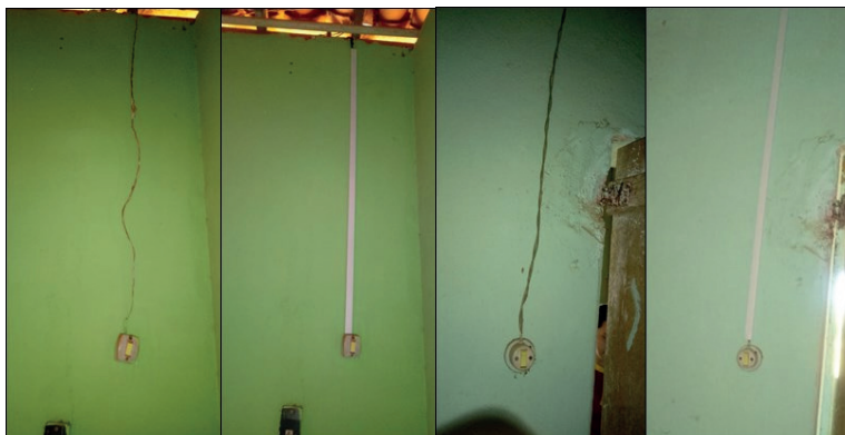
Figs. 10 e 11: Antes e depois de instalações de lâmpadas nas quais foram adicionadas canaletas para isolamento dos fios.
