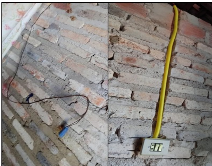
Figura 17: Antes e depois de instalação na qual foi adicionado o eletroduto com uma tomada e dois interruptores. Nessa residência em especial foram feitas instalações embutidas por já possuir os espaços necessários na parede.
