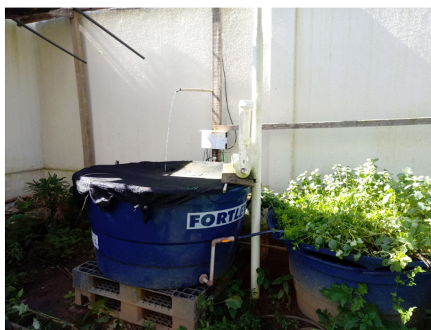
Figura 4. Funcionamento do sistema depois de 4 meses da sua instalação.
