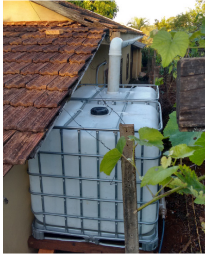
Foto3 – Captação de água de chuva
