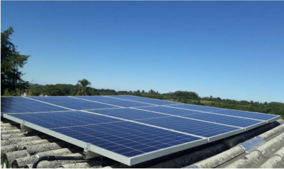
Figura 3: Telhado da Implantação dos Painéis Fotovoltaicos
