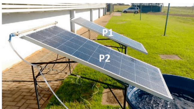
Figura 2 – Sistema Fotovoltaico solar com e sem resfriamento à água
