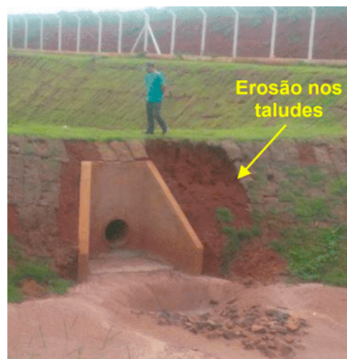
Figura 14 – Erosão nos taludes (Exemplo 2)
