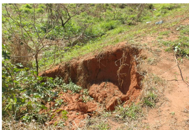
Figura 13 – Erosão nos taludes (Exemplo 1)
