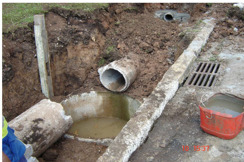
Figura 3: sistema de retenção e infiltração das águas pluviais interligado com a galeria de águas pluviais.
