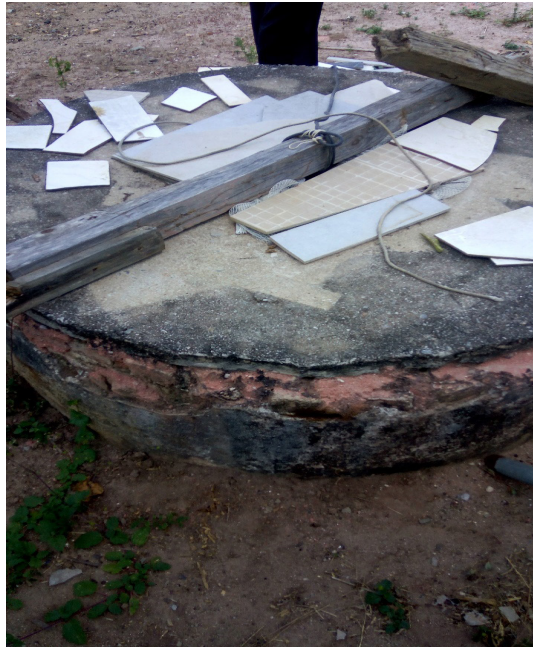
Figura 2: Cisterna com revestimento corroído coberta, em parte, com piso.
