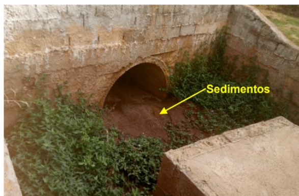
Figura 19 – Acúmulo de sedimentos na estrutura de lançamento de água da BD no curso d'água
