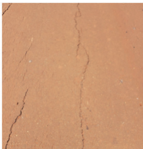
Figura 7. Trinca isolada – longitudinal
