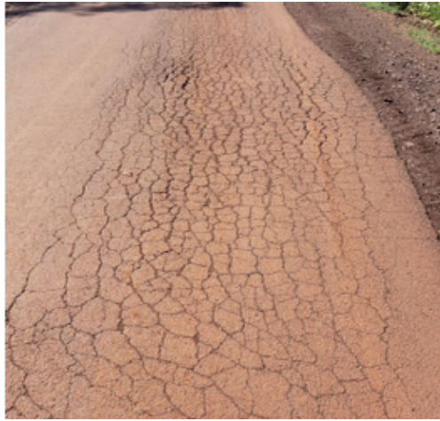
Figura 9. Trinca tipo jacaré e escorregamento
