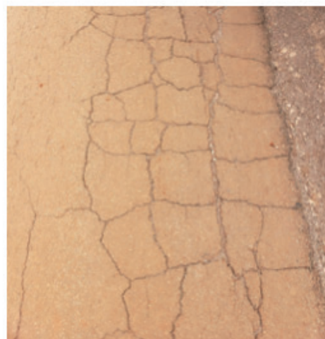
Figura 8. Trinca interligada – tipo bloco
