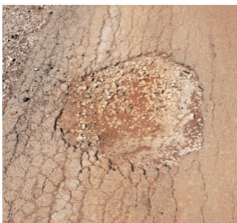
Figura 5. Painela/Buraco e trincas interligadas
