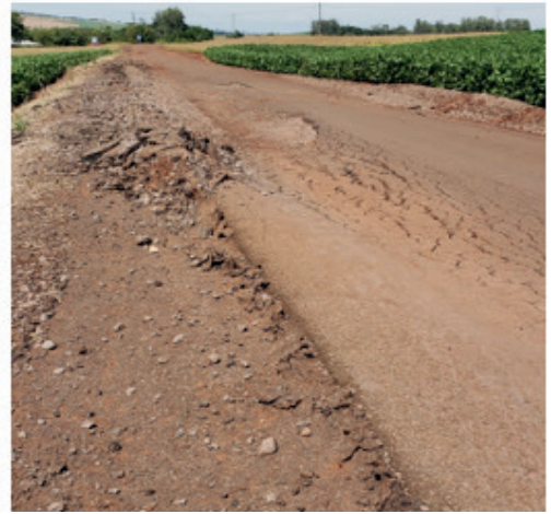
Figura 10. Afundamento de trilha de roda
