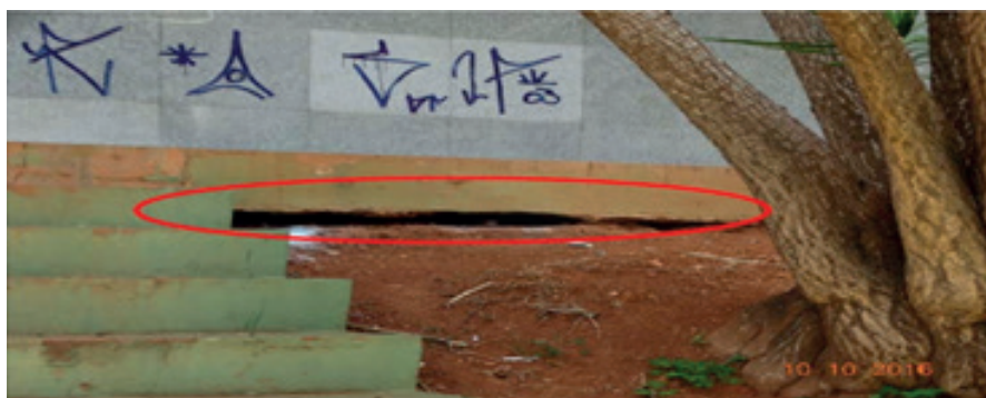
Figura 20 – Falha na parte interior da calçada externa na fachada norte.
