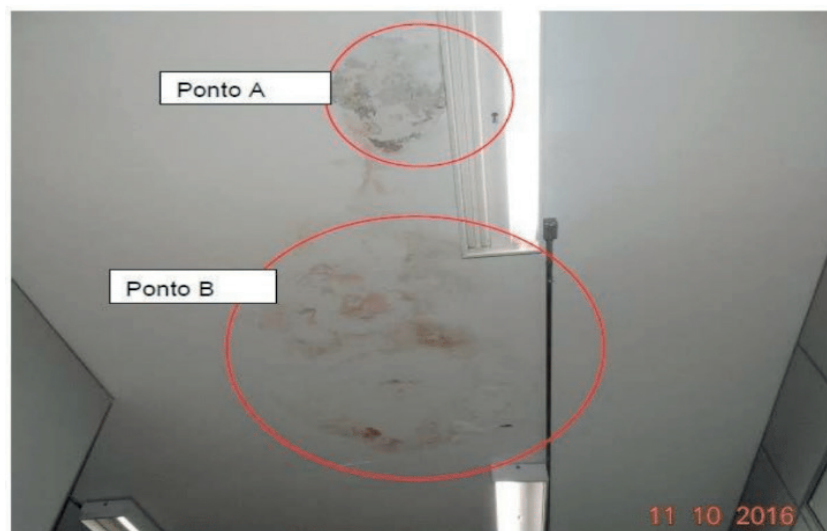
Figura 07 – Ponto de infiltração na laje de cobertura do corredor do Detran.
