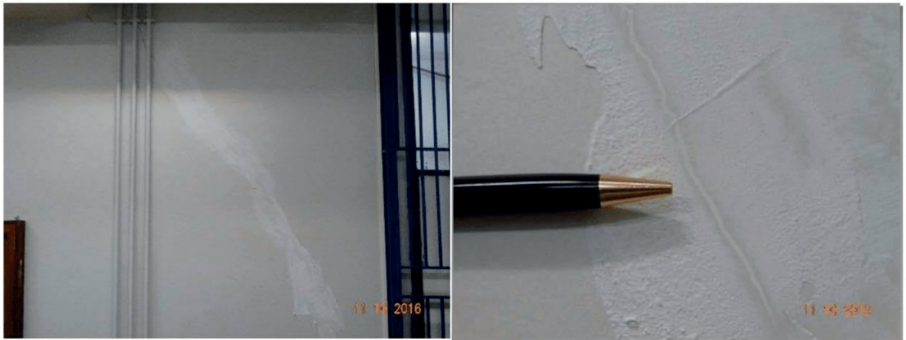
Figura 17 – Monitoramento da rachadura na alvenaria interna no canto esquerdo da sala do cofre, aparentemente não ativa.
