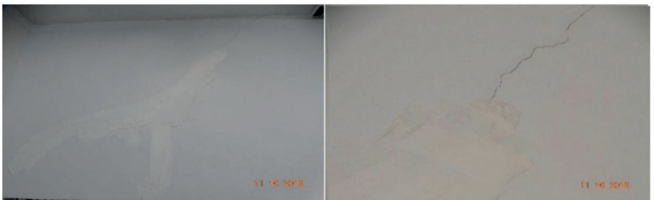
Figura 16 – Monitoramento da trinca na alvenaria interna acima da porta de acesso do cofre, aparentemente não ativa.
