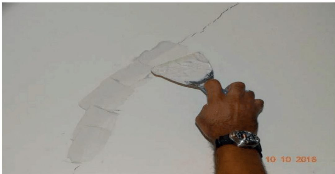
Figura 12 –Trinca em alvenaria da edificação.
