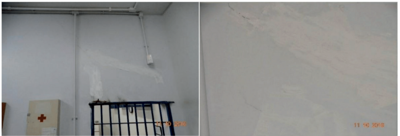
Figura 15 – Monitoramento da rachadura na alvenaria externa acima da porta de acesso do cofre, aparentemente não ativa.
