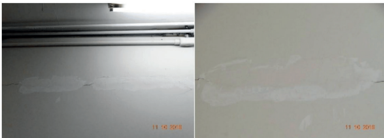
Figura 13 – Monitoramento da rachadura na parede externa do cofre, aparentemente não ativa.
