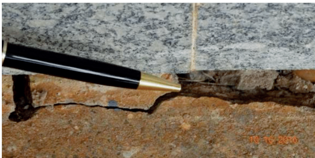
Figura 21 – Abertura entre piso e parede.
