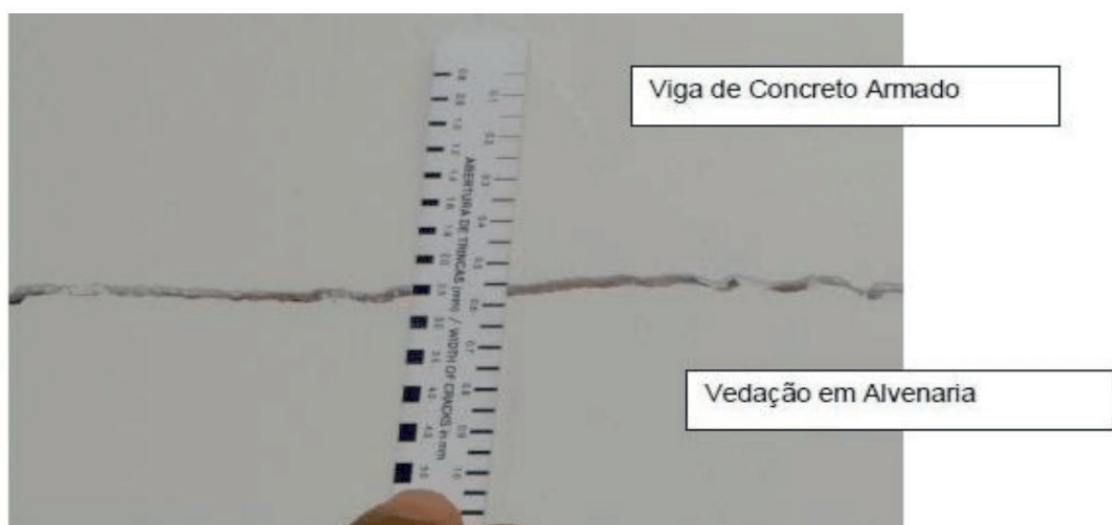
Figura 09 – Rachadura na parede externa da sala do cofre.
