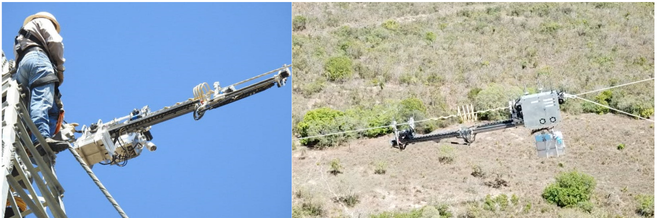
Figura 8: Teste linha desenergizado - Xingu 800 kV.
