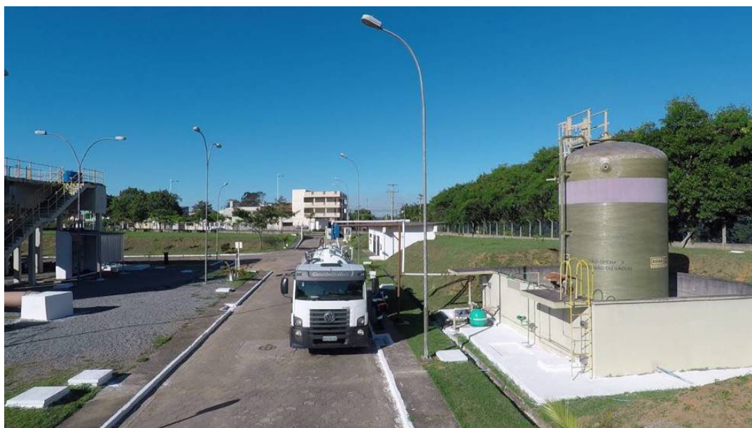
Figura 3. Sistema de tratamento da água de reuso (ampliação).
