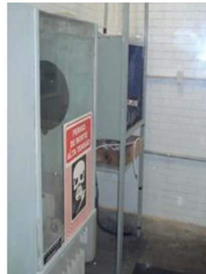
Figura 8. Equipamento de Alta Tensão Fonte: Acervo autores.
