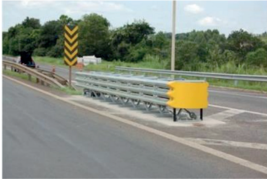
Figura 4: Amortecedor de impacto na rodovia SP-340 em Mogi Guaçu
