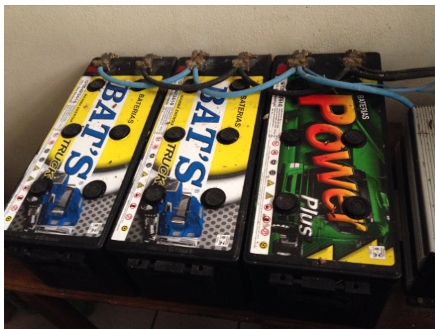
Figura 8 - Banco de baterias
