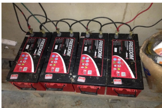
Figura 2 - Banco de baterias
