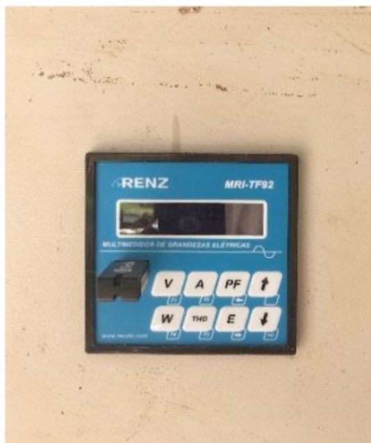
Figura 2. Multimetro de grandezas elétricas instalado no Bloco de Salas Especiais – Unidade Tapajós.
