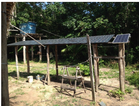
Figura 1- Gerador Fotovoltaico do Sistema de Anã
