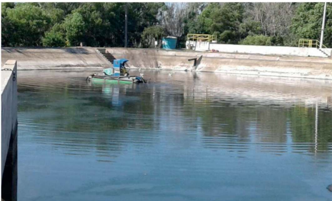
Figura 5. Lagoa anaeróbia da ETE Jacaraípe.
