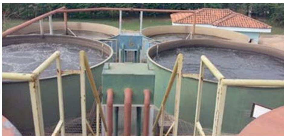
Figura 3 – Vista do tanque aerado e do decantador secundário
