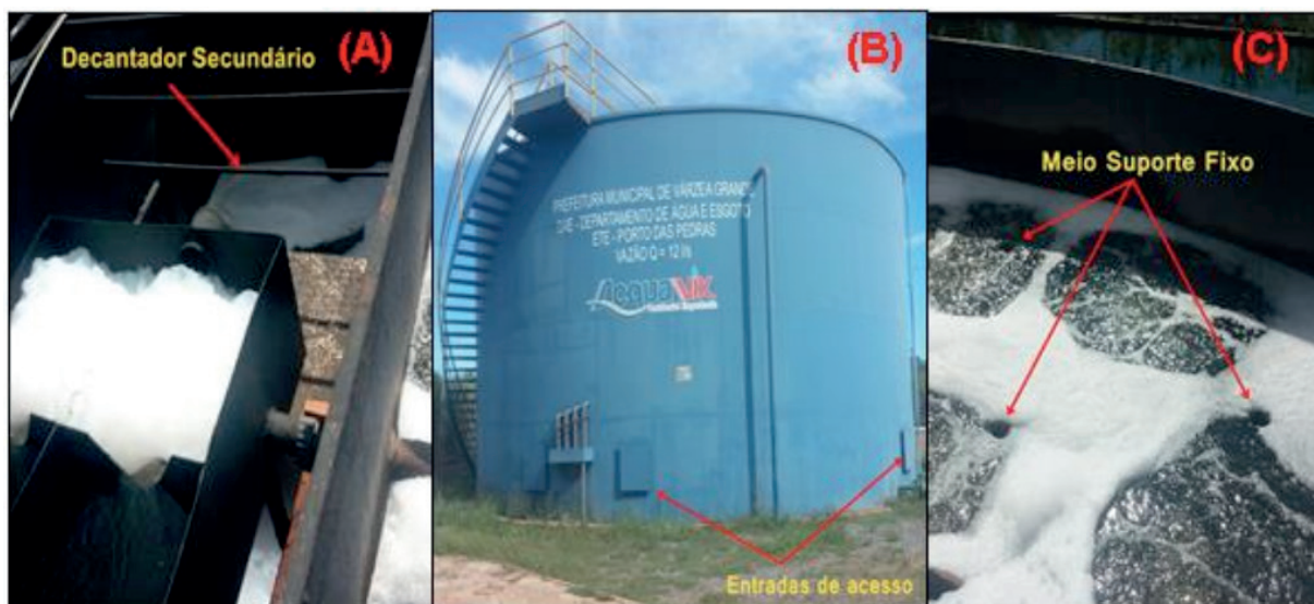
Figura 3 - Unidades do Tratamento Secundário. (A) Decantador Secundário. (B) Unidade Compacta com indicação das entradas de acesso da mesma. (C) Indicação do Meio Suporte Fixo no FBASN.
