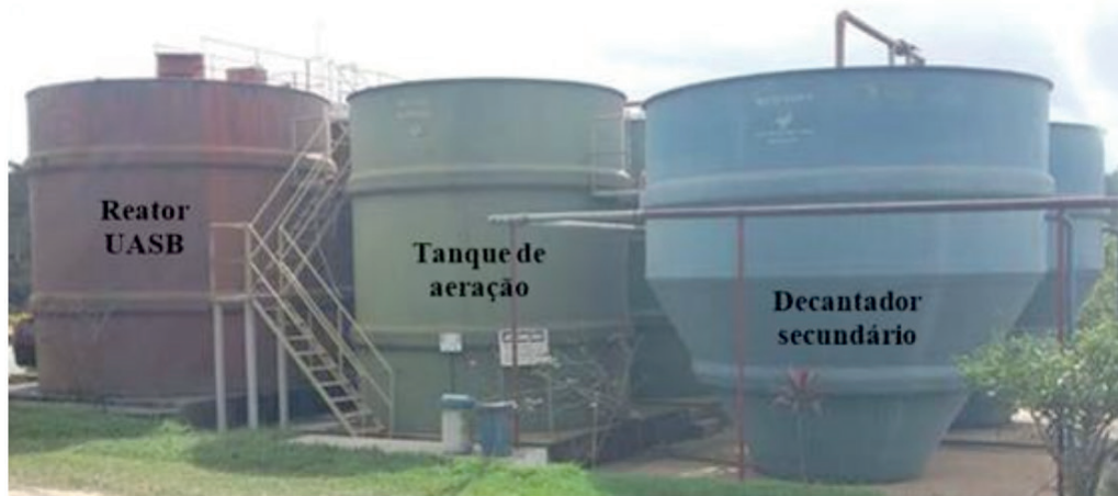
Figura 1 - Foto da disposição das unidades da ETE
