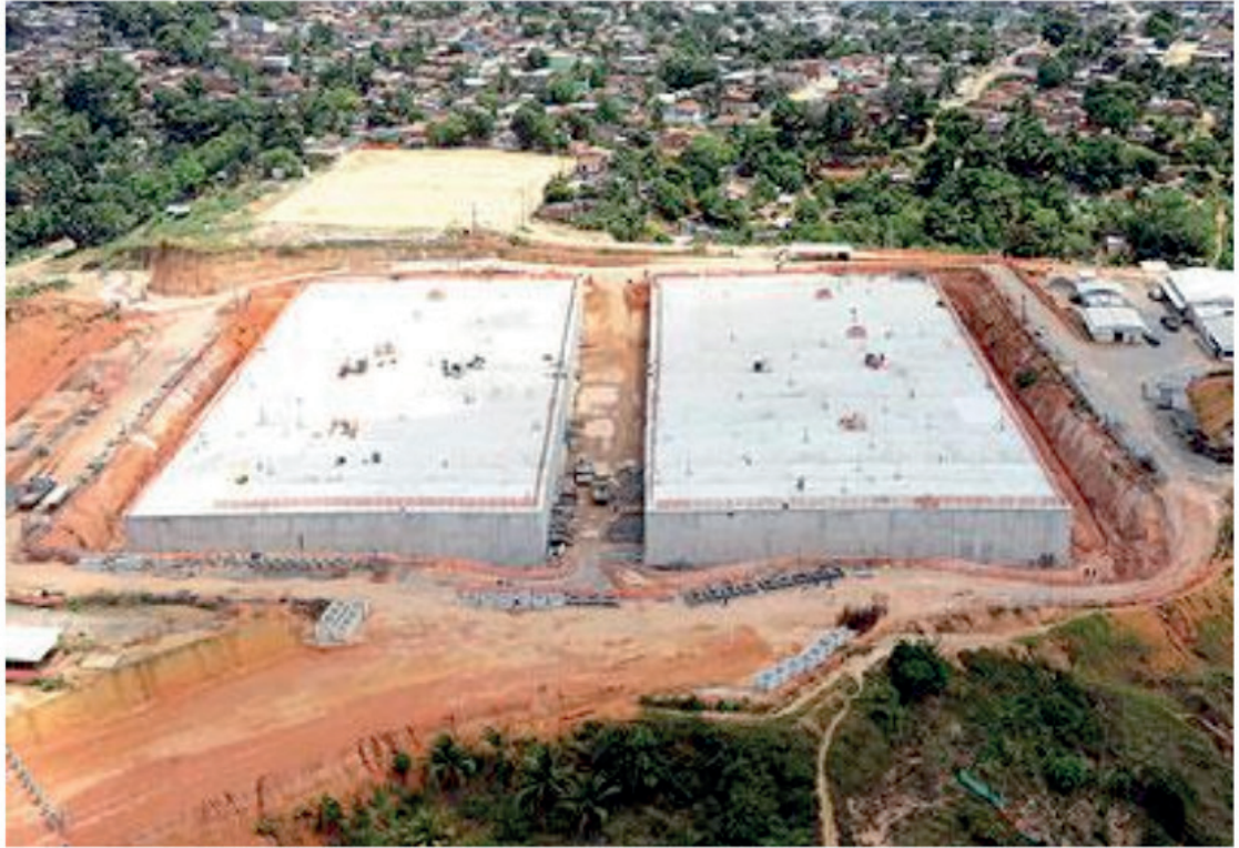
Figura 10 - Reservatório do Jordão dividido em duas câmaras
