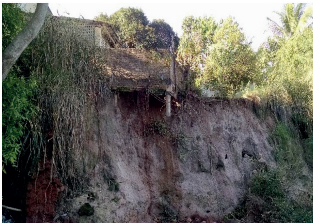
Figura 10 – Erosão na margem esquerda.
