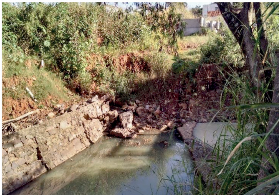
Figura 11 – Erosão na margem direita
