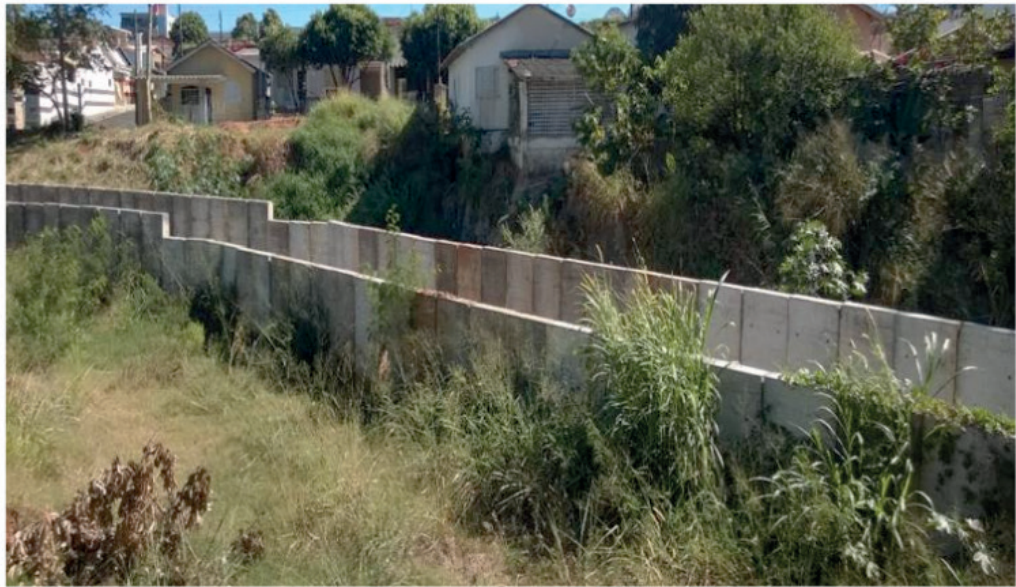
Figura 13 – Canalização vista da Rua Ana Dias.
