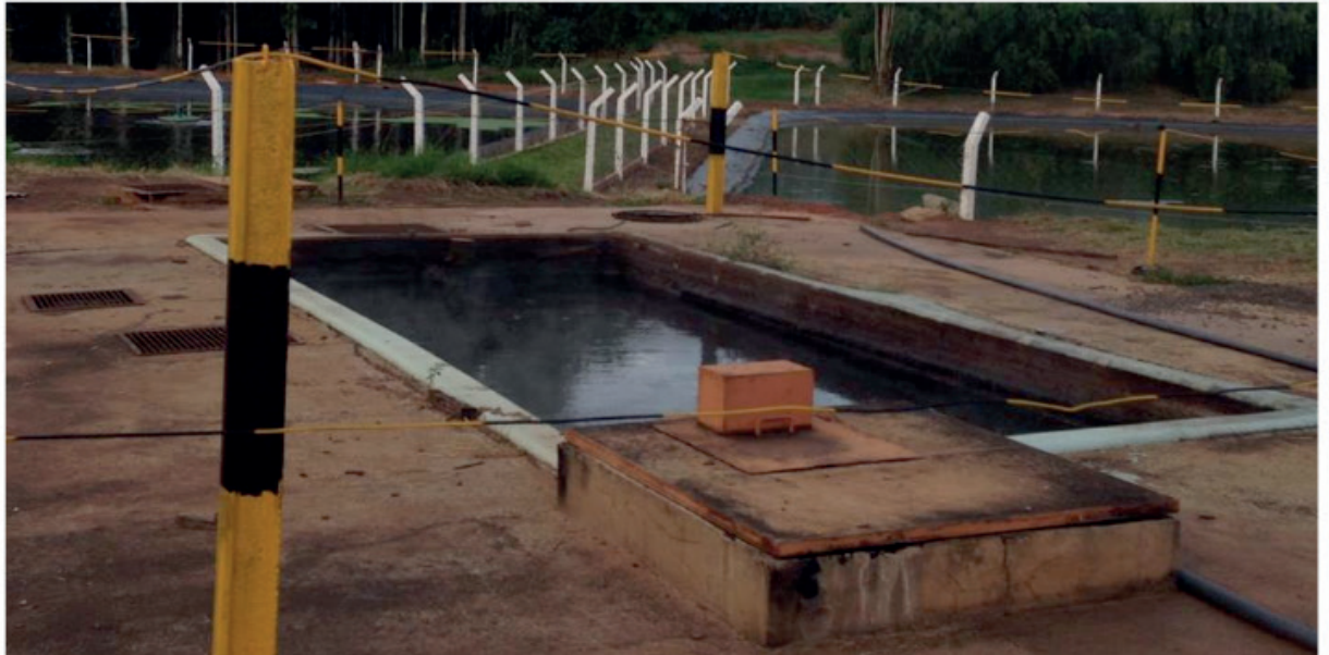
Figura 4 – Vista geral da estação de Tratamento
