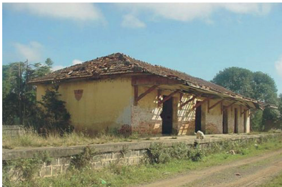
Figura 4. Estação Ferroviária de Paulo Frontin em ruínas, em 2010. Autor desconhecido. Fontes: The Frontin, < https://thefrontin.blogspot.com/ >, 2019; Estações Ferroviárias do Brasil, http://www.estacoesferroviarias.com.br/pr-tronco/paulofrontin.htm .
