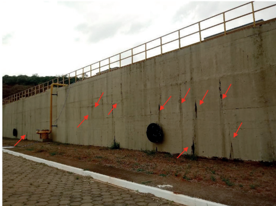
Figura 2 - Reator UASB da ETE pesquisada com fissuras (setas).
