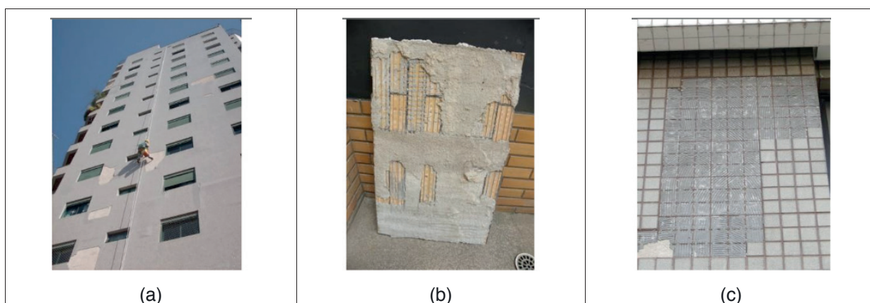
Figura 1 – (a) Vista geral da fachada do edifício “JA” com áreas de descolamento; (b) vista detalhada do tardo de placas cerâmicas descoladas de fachada do edifício “H” evidenciado por falhas de assentamento; (c) vista detalhada de trecho de fachada do edifício “I” com descolamento de revestimento cerâmico, evidenciado por falhas de assentamento.
