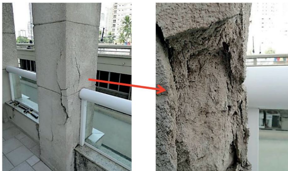
Figura 1 – Sintomas observados: expansão e fissuração com esfarelamento do sistema de revestimento das fachadas.
