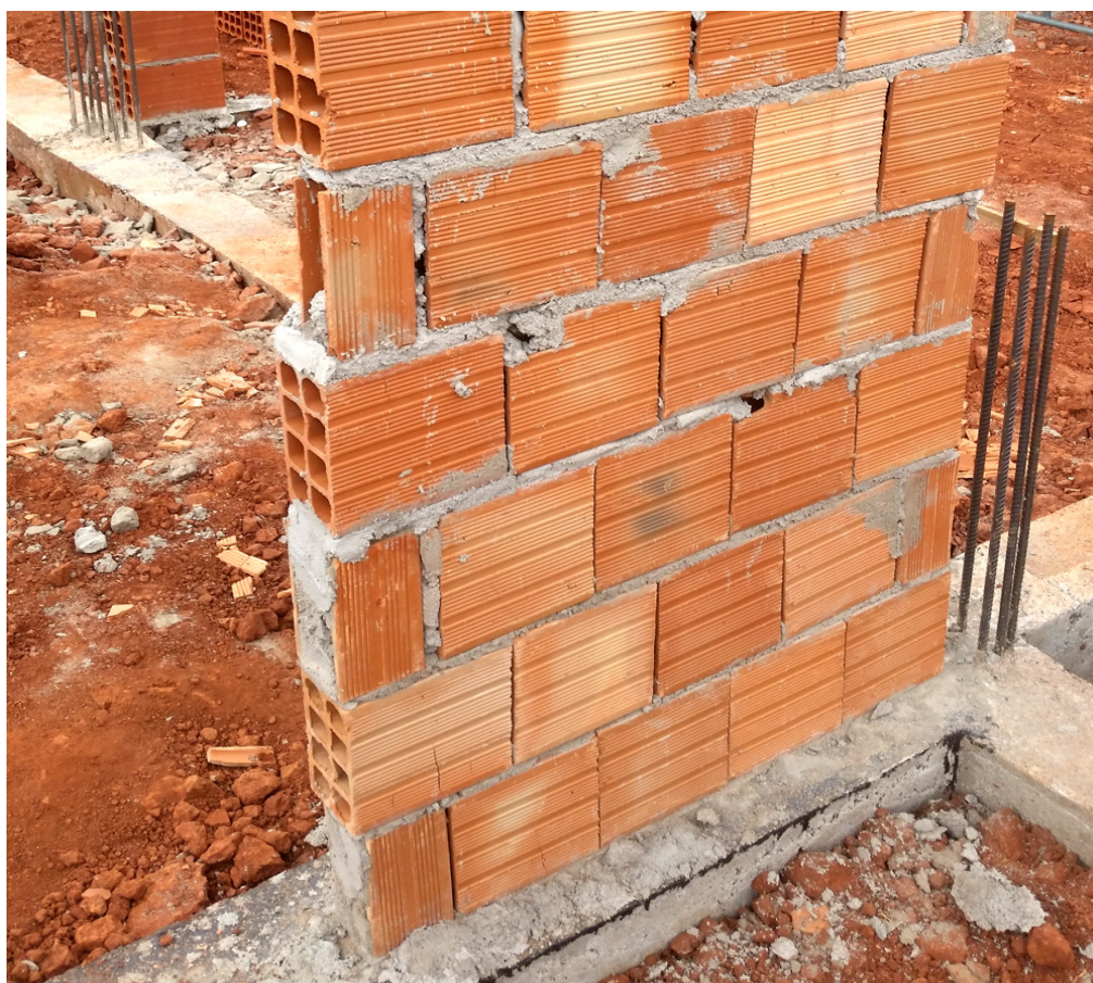
Figura 8 - Diferença de espessura entre vigas baldrame e alvenaria
