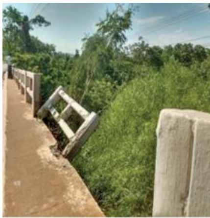
Figura 6. Guarda corpo avariado e inexistente
