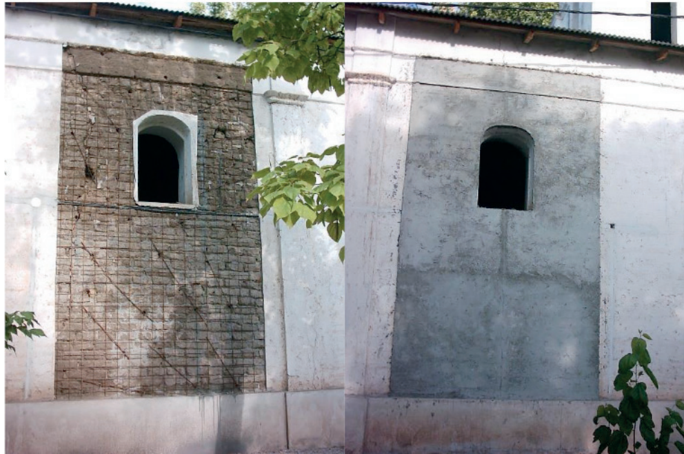
Fig. 6: Fachada Este: Izq. Refuerzos de malla y conectores. Der. Revoque grueso cementicio. (Fuente: Genovese F; 2006)
