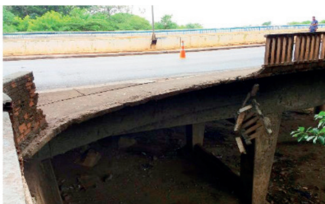
Figura 12. Parte do passeio sem guarda-corpo
