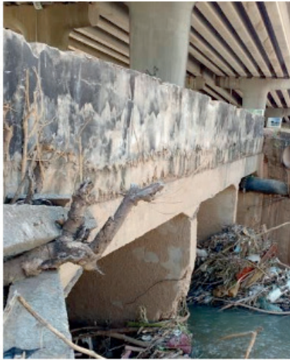
Figura 4. Deterioração do canal sob o viaduto
