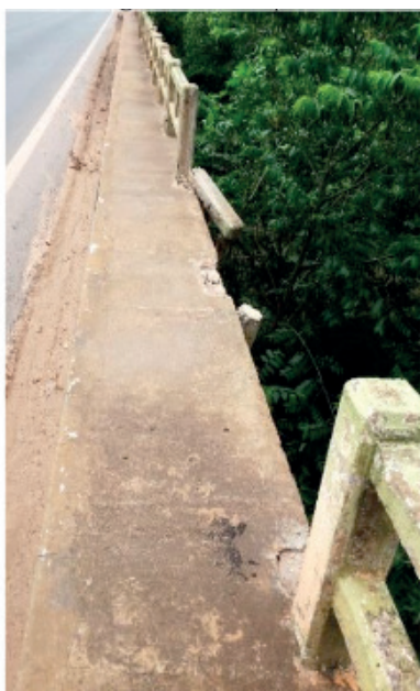
Figura 10. Avarias e inexistência de guarda-corpo
