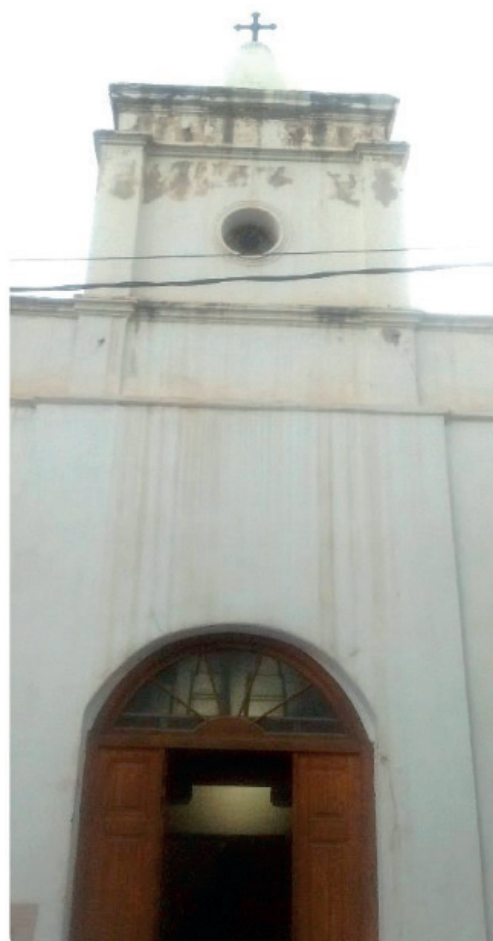
Fig. 5: Deterioros en la fachada Norte de la Iglesia Parroquial Ntra. Sra. del Carmen. (Fuente: propia, 2019)
