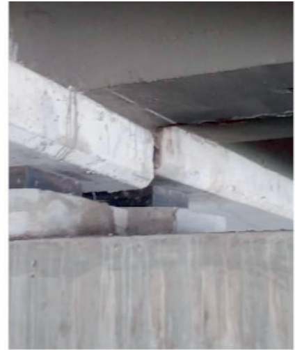
Figura 5. Deslocamento entre vigas de apoio
