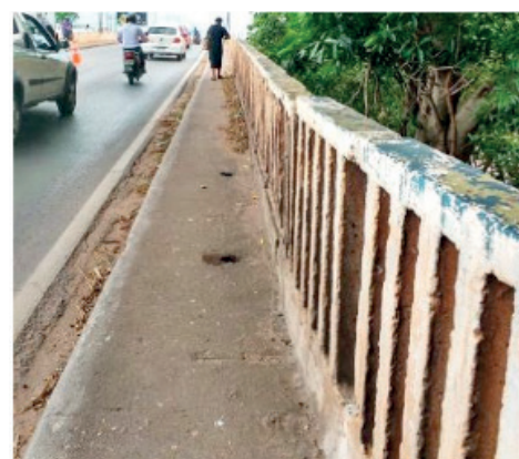
Figura 13. Passeio não adequado à norma
