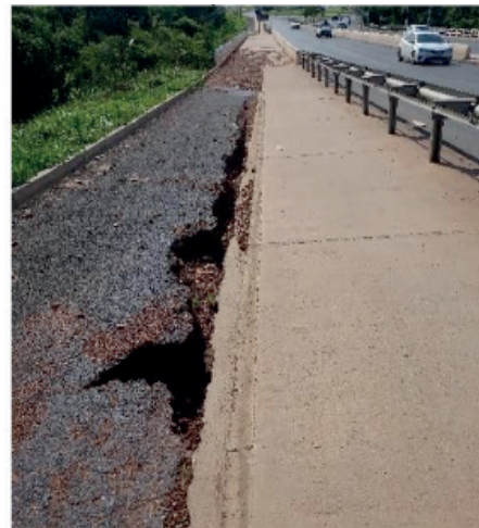
Figura 9. Fissura no acesso de pedestres à ponte
