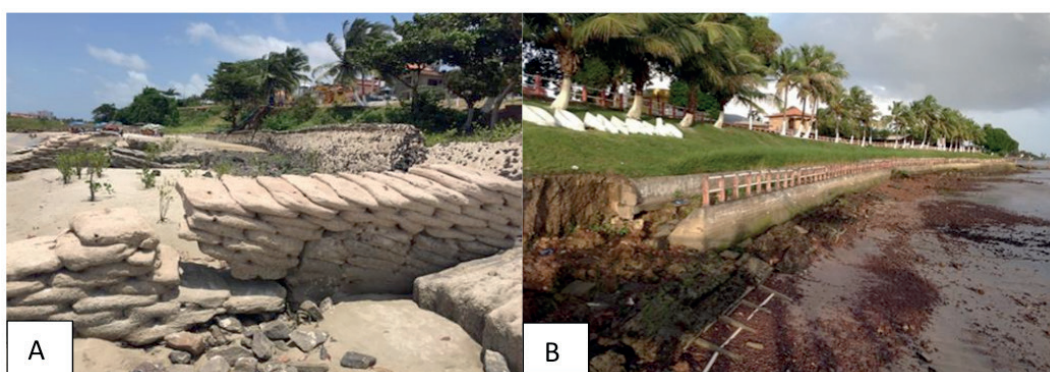
Figura 6 – A) Sacos de areia e concreto para conter a erosão costeira no município de Salinópolis-PA; B) muro de contenção parcialmente destruído na orla de Soure-PA (Fotos: Milena Andrade)
