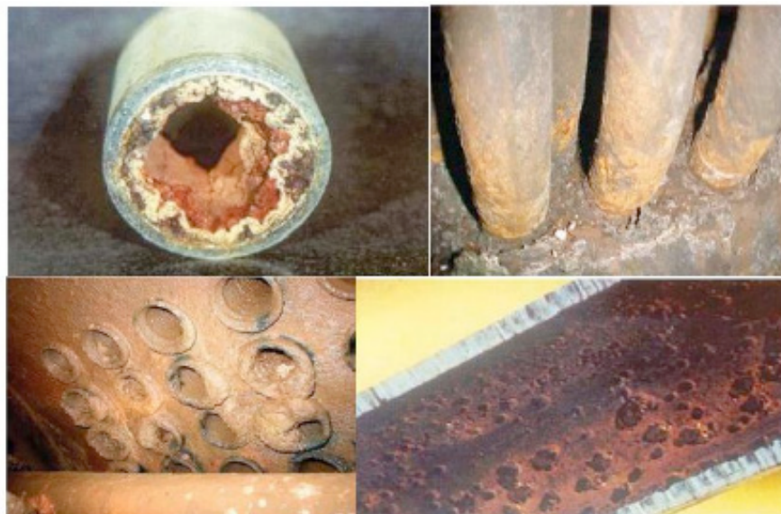
Figura 1 - Corrosão nas tubulações
