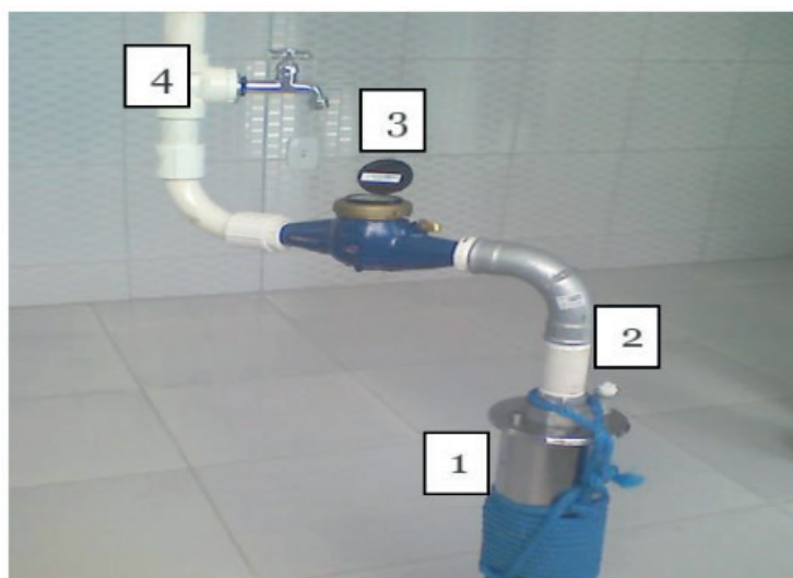
Figura 7: Modelo fotográfico de instalação dos dispositivos para outorga do poço artesiano.
