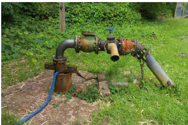
Figura 5: Vista geral do poço artesiano em funcionamento na cidade universitária.
