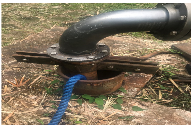
Figura 6: Vista parcial da boca do poço artesiano.
