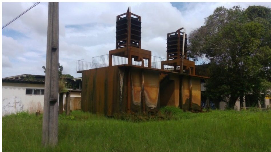
Figura 4: Vista parcial da estação de tratamento de água da cidade universitária.
