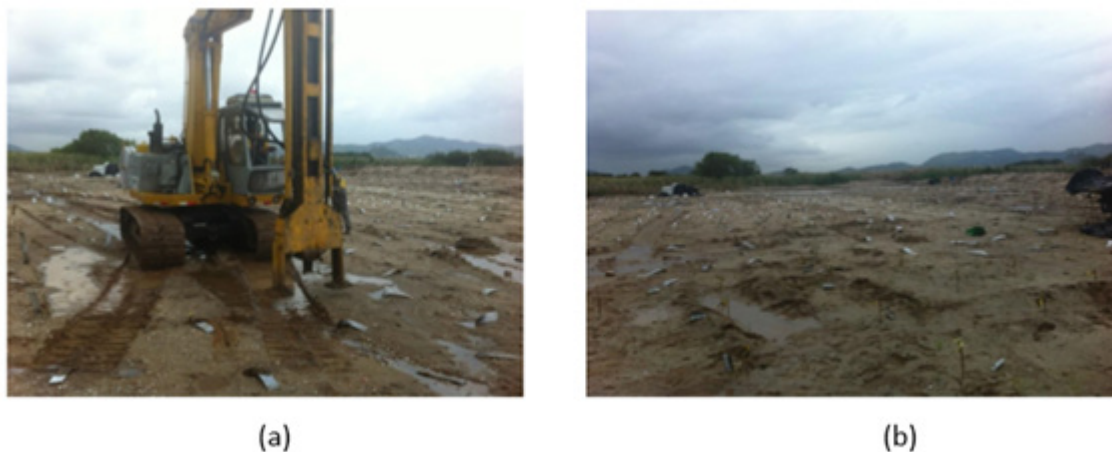
Figura 6 - (a) Cravação de drenos fibroquímicos, (b) Locação de drenos e marcação de drenos fibroquímicos executados (ADAPTADO DE GEOCONSULT, 2012)
