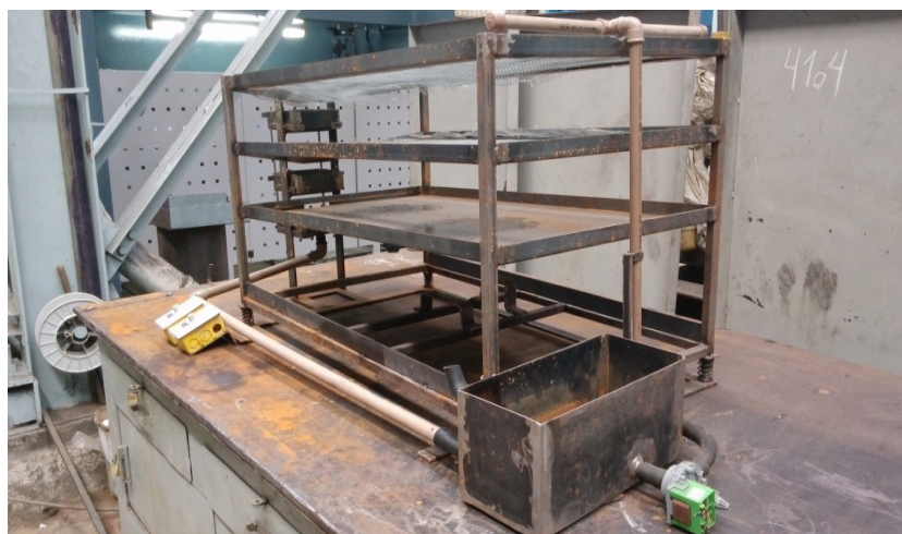
Figura 5: Bomba, Reservatório e Tubulações.
