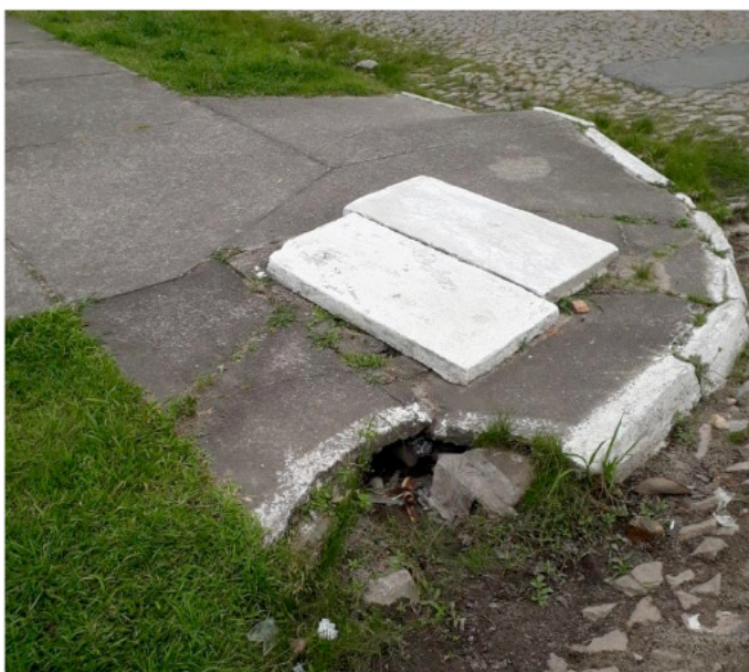
Figura 10: Boca de Lobo em mau estado de conservação.
