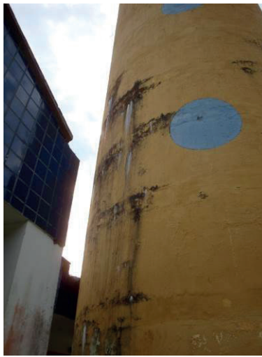
Figura 10 – Reservatório não estanque
