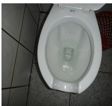
Figura 8 – Exemplo de falta de estanqueidade nos aparelhos de descarga de bacias sanitárias
