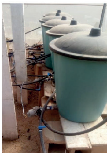
Figura 4a- Reservatórios de irrigação e Eletrobombas.
