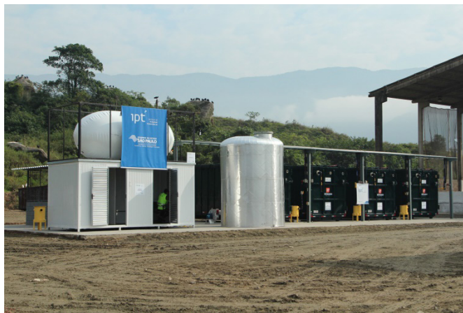
Figura 1 – Planta piloto de biodigestão - túneis de metanização CMethar
