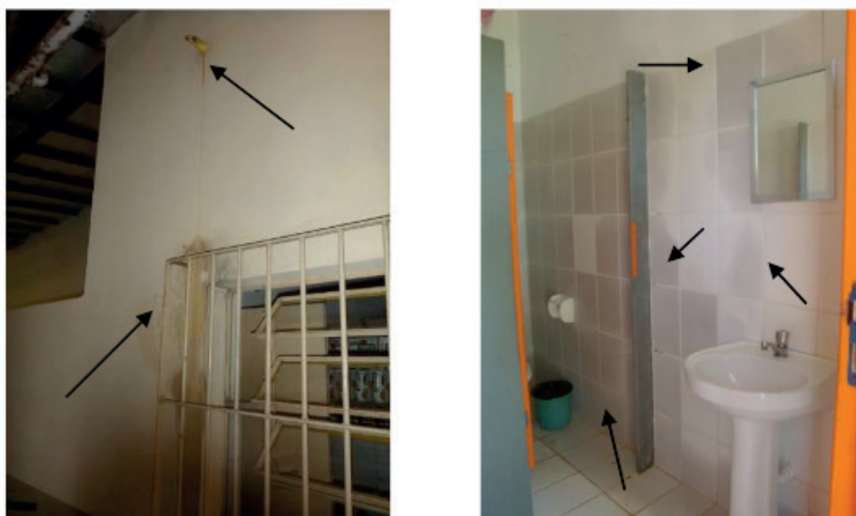
Figura 9 – Efeitos do vazamento de reservatórios sobre lajes
