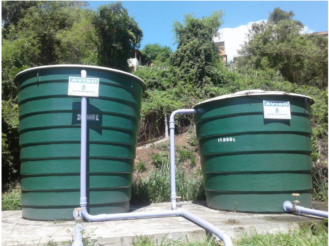
Figura 4. Reservatórios ETE Bandeirantes - capacidade total de 35 m 3 .
