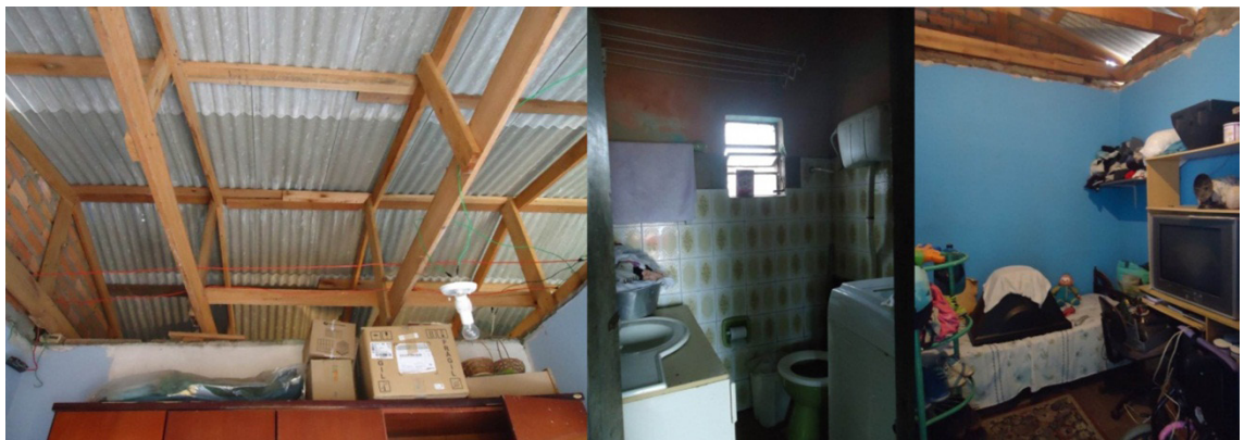
Figura 4: Telhado sem forro, banheiro e um dos quartos. Fonte: ASCPOA.
