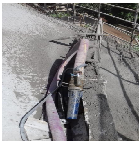
Figura 1: Bico de projeção, local onde a mistura do cimento com os agregados, mistura com a água.
