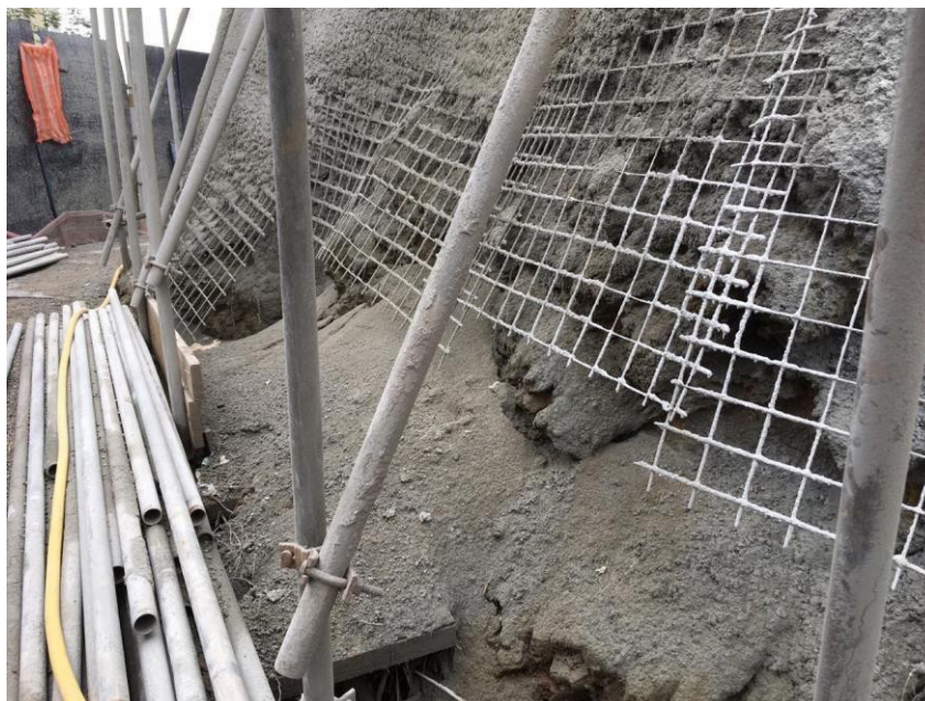
Figura 5: Desperdício de material devido à não adesão da mistura no talude.
