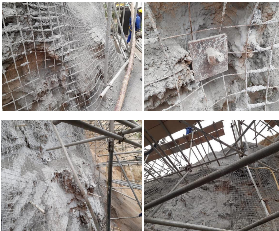
Figura 11: Pontos de concretagem com espessuras superiores a de projeto. Fonte: elaborado pelos autores.
