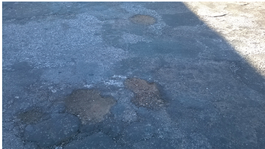
Figura 1: Alguns dos muitos buracos encontrados em Uruaçu-GO
