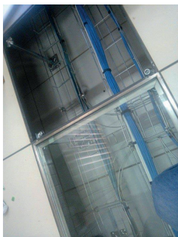
Figura 4 - Organização original do cabeamento
