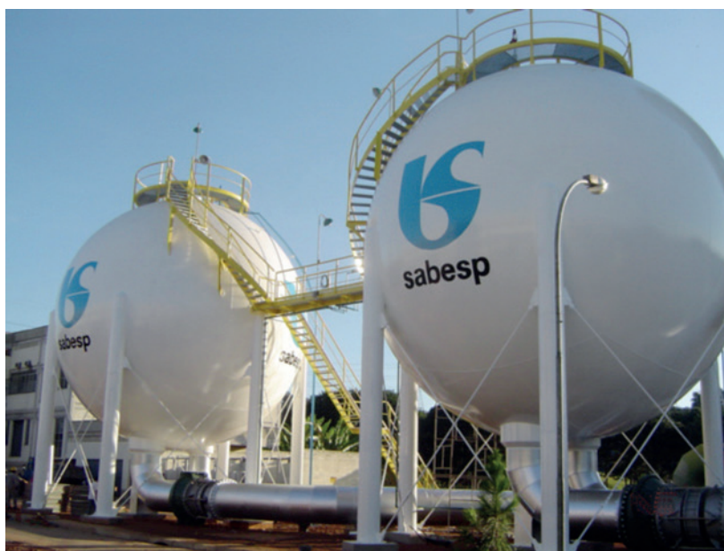
Figura 3. Reservatório hidropneumático da Adutora Guarapiranga, Alto da Boa Vista, zona sul de São Paulo.
