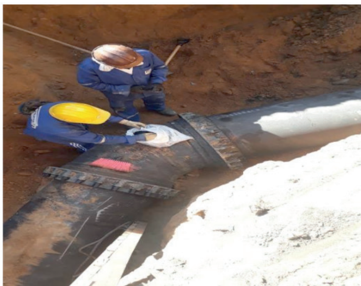
Figura 07: Junta Travada Externa
