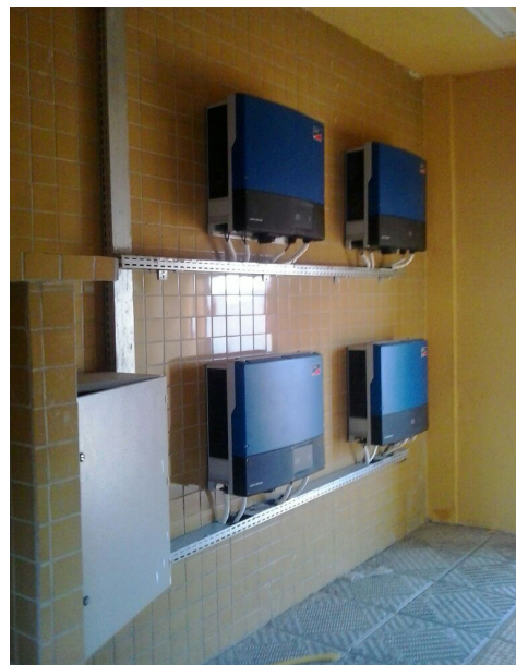
Figura 04: Inversores do sistema do IFRN campus Pau dos Ferros.
