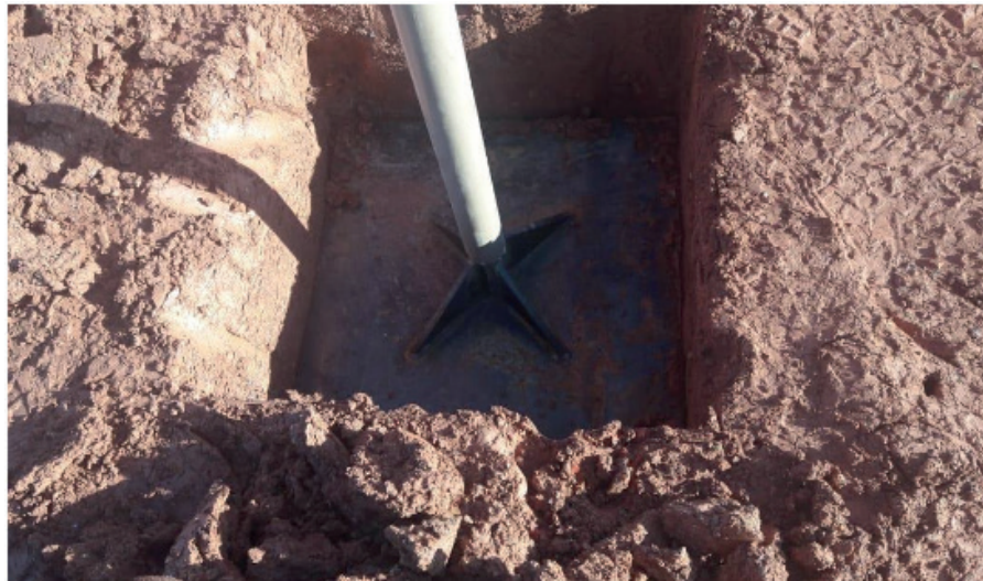
Figura 5 - Cava (remoção de solo) pronta já com a placa de recalque inserida.
