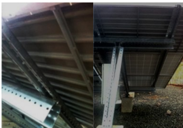
Figura 8 - Sistema arrefecedor/módulo PV instalado na UFV (SILVA et al., 2018b).
