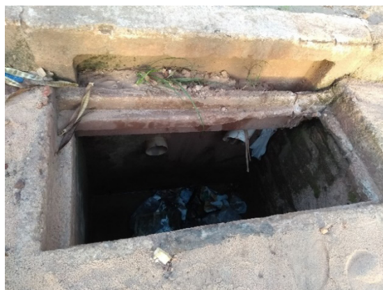
Figura 5: Boca de Lobo sem grelha e entupida de sedimentos (areia).
