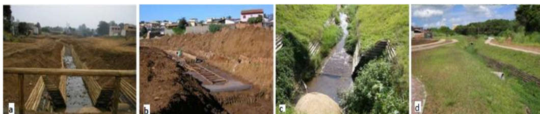
Figura 2: Obra de renaturalização do canal do Córrego Tijuco Preto, em paliçada, gabiões e geotêxteis para suportar a nova vegetação (a, b) e Córrego Tijuco Preto já renaturalizado, um ano após a obra (c, d). Fotos cedidas pelo Prof. Dr. Renato Anelli (IAU/USP).
