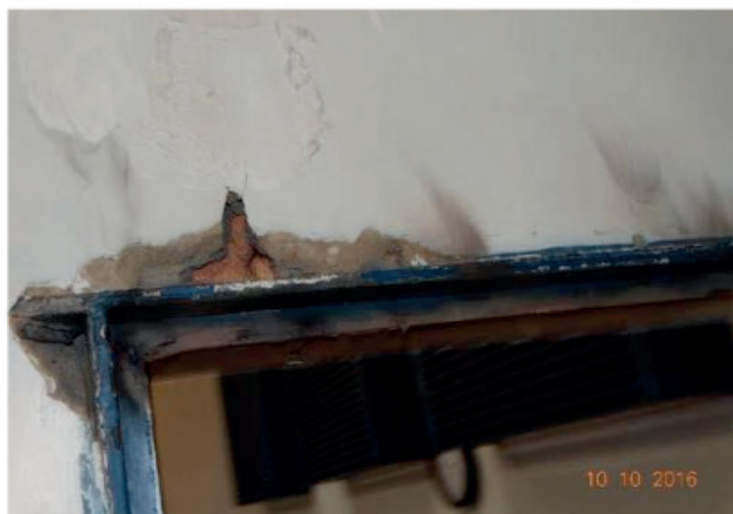
Figura 11 – Porta de entrada ao cofre sem verga.
