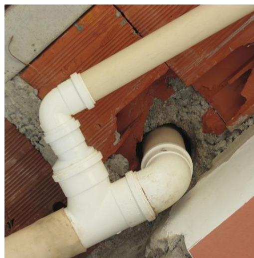
Figura 3-b: Furo na laje
