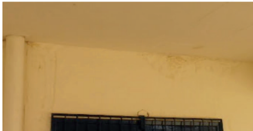
Foto 11 – Refeitório. Ocorrência de bolor, eflorescência e infiltração.
