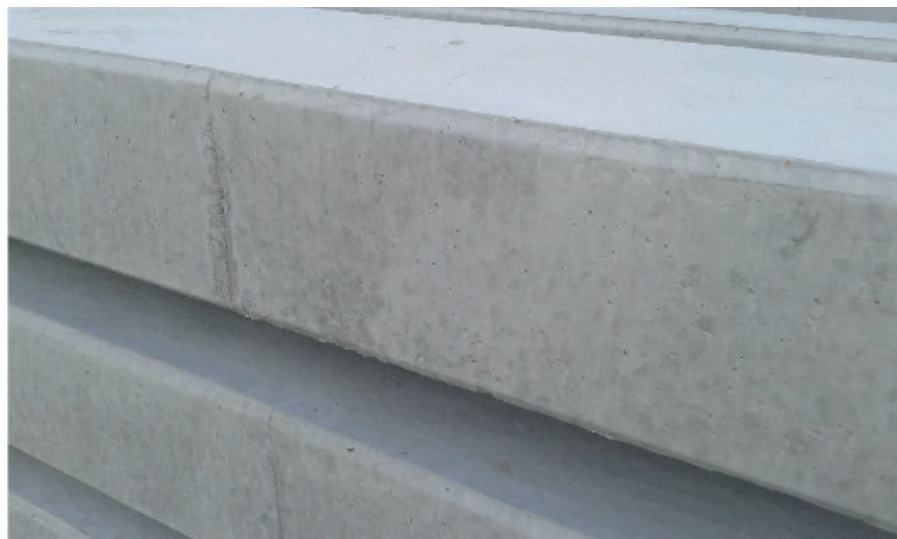
Figura 2 – Manchas/ Fonte: Autor
