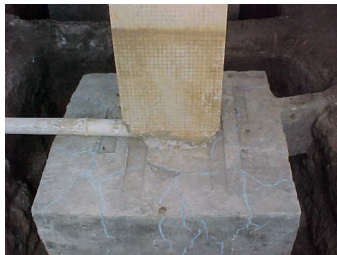
Figura 2 – Fissuras na face superior do bloco.
