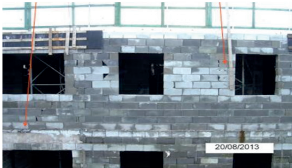
Figura 5 – Bicheira em viga e blocos perfurados.
