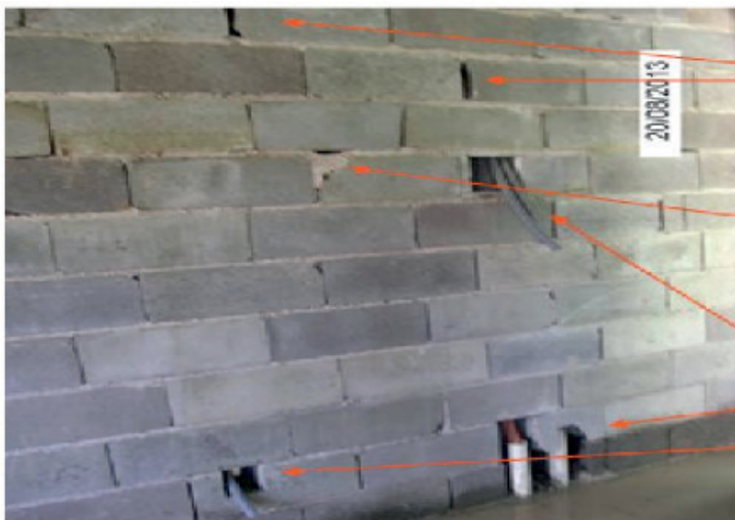
Figura 2 – Juntas verticais não preenchidas e alvenaria rasgada.
