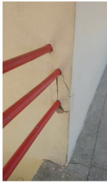
Foto 09 – Refeitório. Fissuras na parede.
