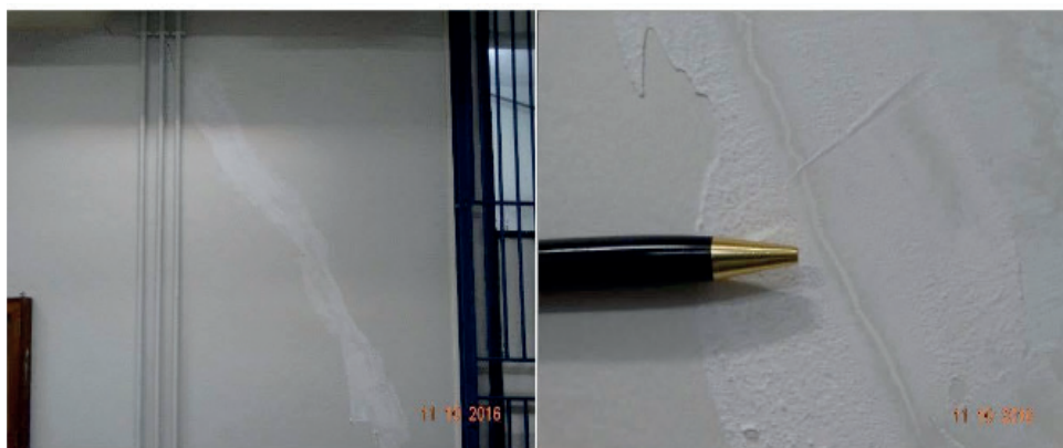
Figura 17 – Monitoramento da rachadura na alvenaria interna no canto esquerdo da sala do cofre, aparentemente não ativa.
