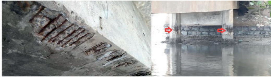
Figura 3: Corrosão das armaduras e desagregação do concreto em estágio avançado nas estruturas da ponte.
