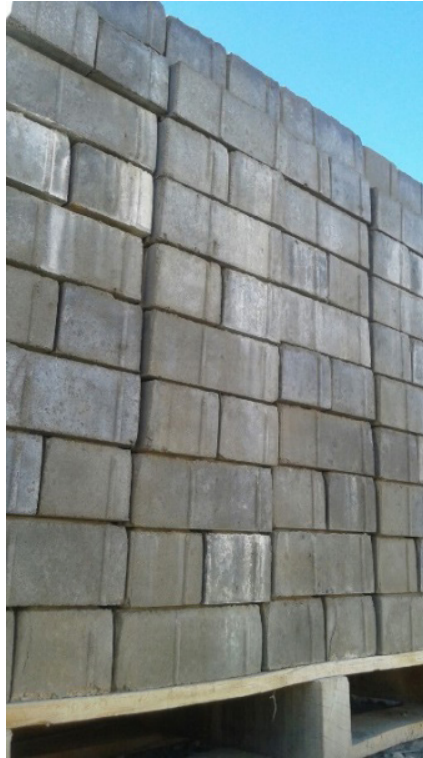
Figura 4 – Eflorescência Fonte: Autor
