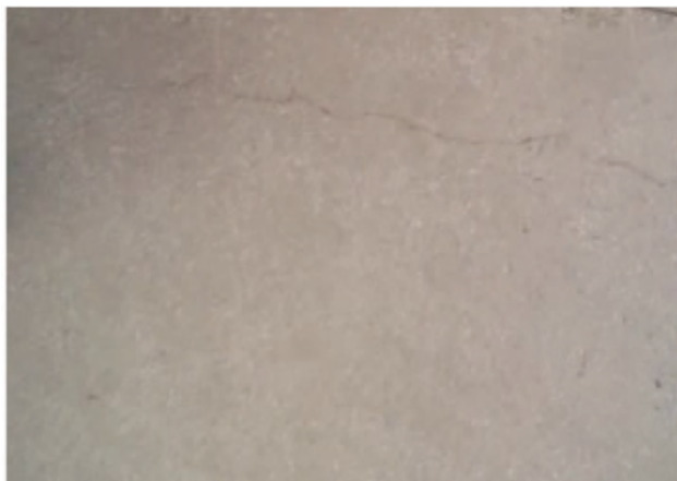
Foto 19 – Sala 1. Presença de Fissura no chão.
