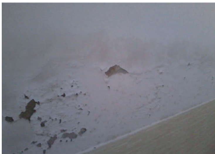
Figura 9 – Descolamento da tinta em parede de alvenaria exposta ao ambiente externo.
