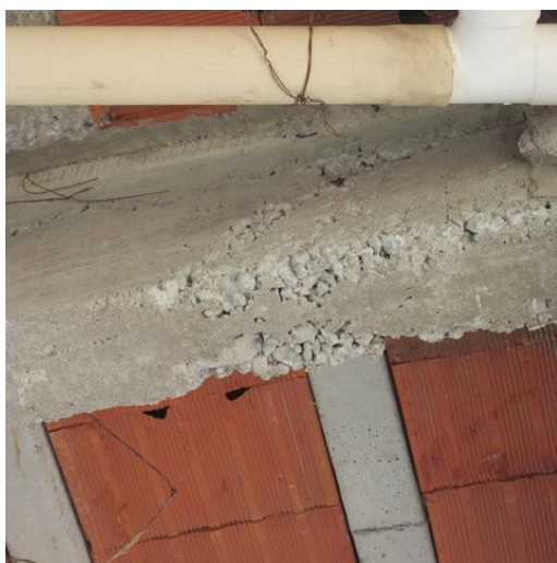
Figura 3-a: Segregação do concreto na viga
