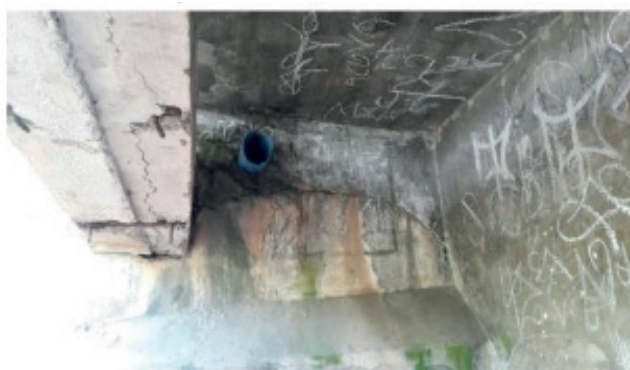
Figura 5: Bolor presente na estrutura da ponte.
