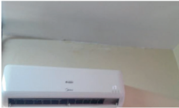
Foto 25 – Sala 4. Presença de bolor.
