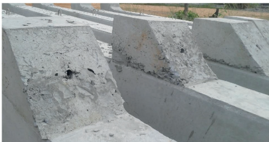
Figura 9 – Ocorrência de Falhas de Adensamento/ Acabamento/
