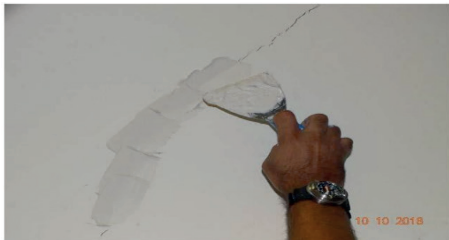
Figura 12 –Trinca em alvenaria da edificação.
