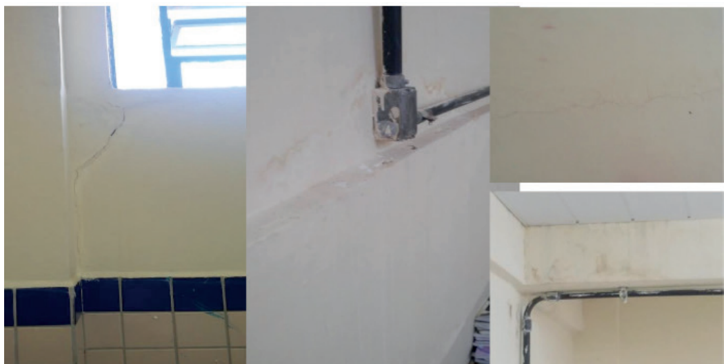
Foto 28 – Biblioteca. Presença de Fissuras, eflorescência e bolor.
