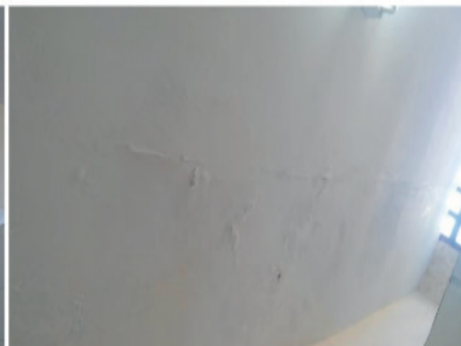
Foto 14 – Banheiro Feminino. Presença de bolor e fissuras.
