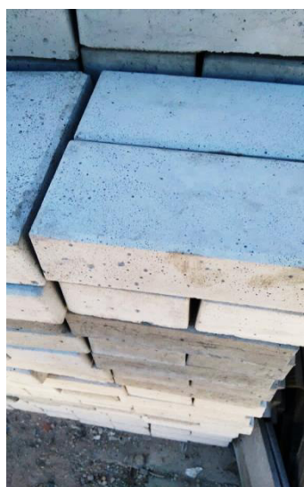
Figura 2 – Bolhas na superfície dos pavers.
