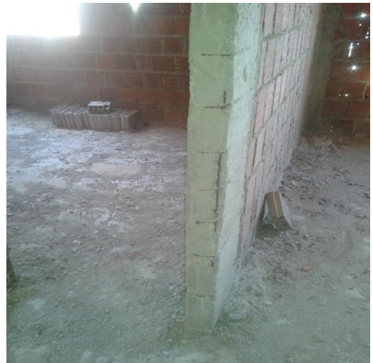
Figura 9-b: Pilar sem cobrimento
