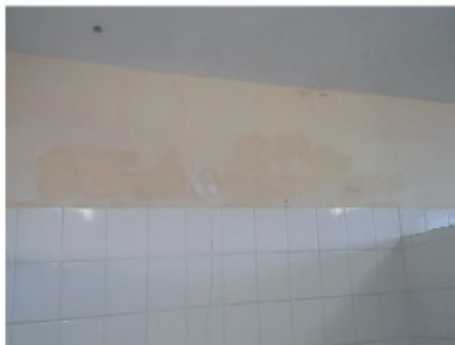
Foto 13 – Banheiro Feminino. Presença de eflorescência e infiltração.
