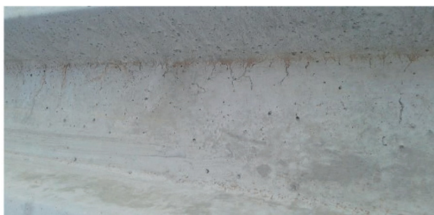
Figura 4 – Fissuras/ Fonte: Autor
