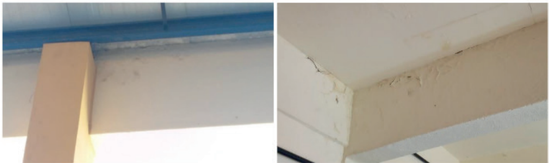
Foto 27 – Parte da Frente Externa. Presença de bolor.
