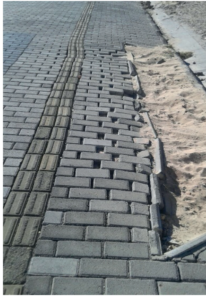
Figura 7 – Contenção lateral quebrada
