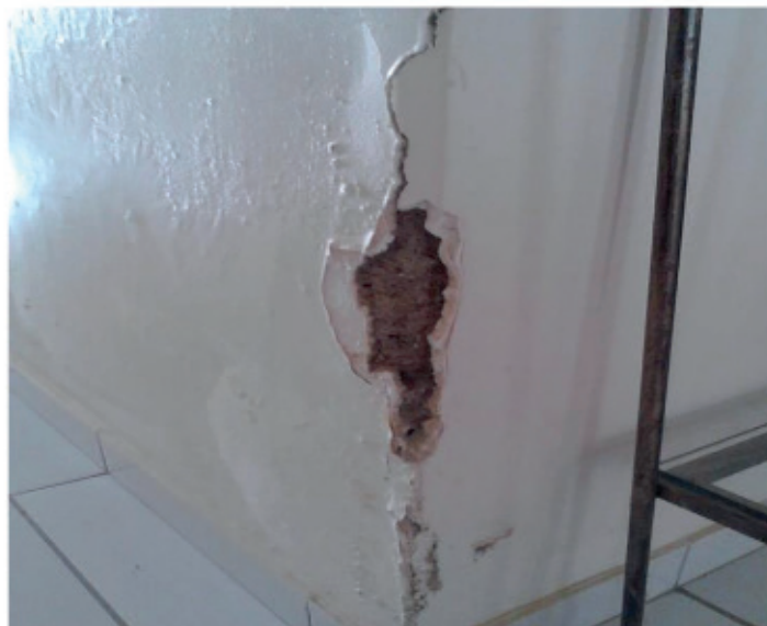
Figura 6 – Revestimento de pilar deteriorado.
