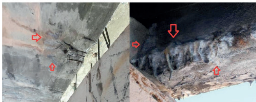
Figura 4: Eflorescência presente nas vigas das estruturas ocasionando estalactites.
