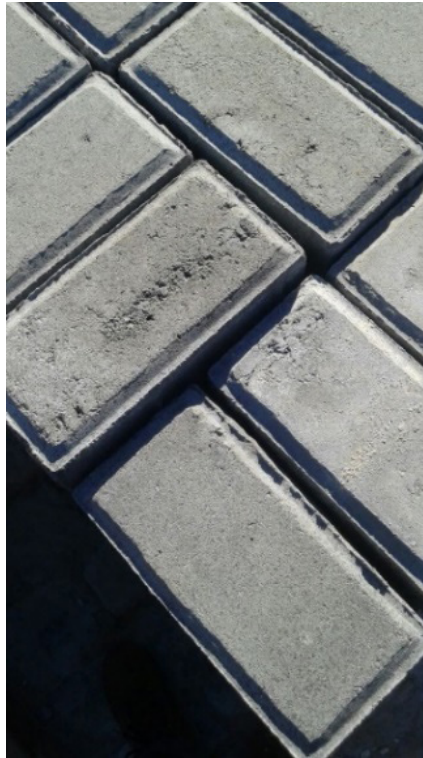
Figura 3 – Ninhos causados por falha de concreto
