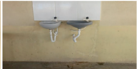
Foto 12 – Refeitório. Ocorrência de bolor e infiltração.
