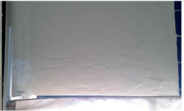
Foto 26 – Sala 4. Presença de eflorescência.
