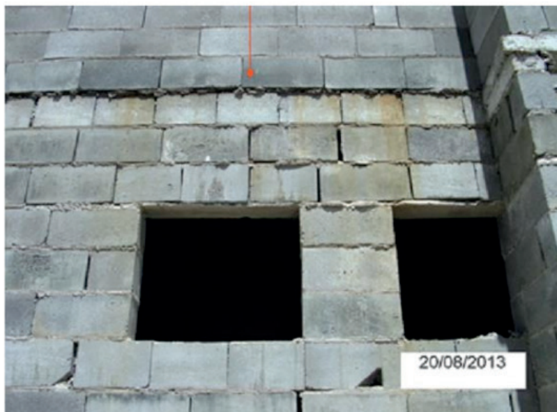
Figura 3 – Parede fora do prumo e desnivelada.
