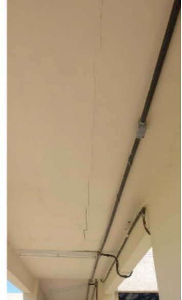
Foto 10 – Refeitório. Fissuras no teto.
