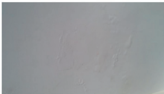
Foto 03 – Banheiro feminino. Ocorrência: bolor no teto.
