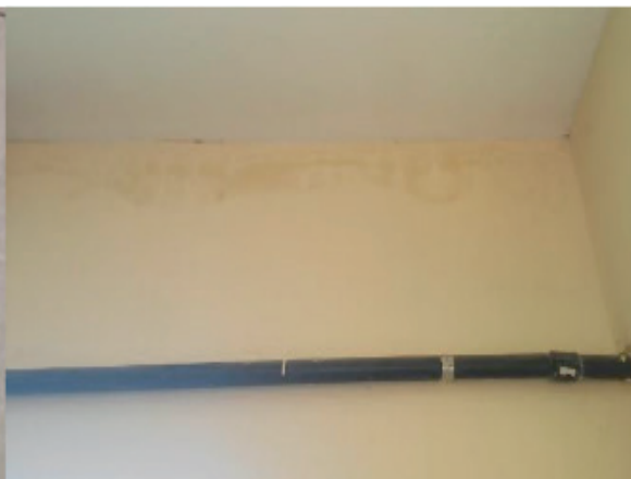
Foto 20 – Sala 1. Presença de eflorescência.
