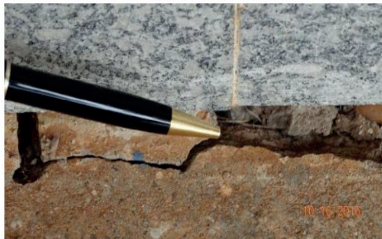
Figura 21 –Abertura entre piso e parede.
