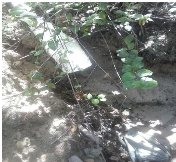
Figura 24 - esgoto despejado diretamente no manguezal.
