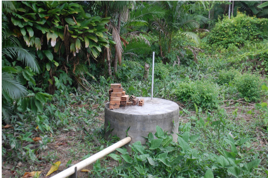
FIGURA 04: Fossa convencional de algumas residências da Ilha de Mapiraí de Baixo (Cametá, Pará).
