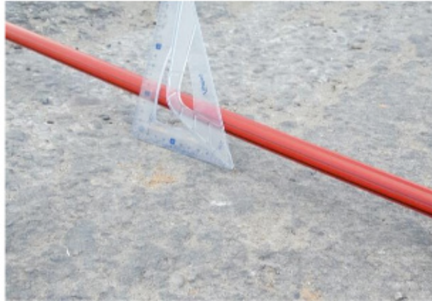
Figura 6. Afundamento local no trecho B.
