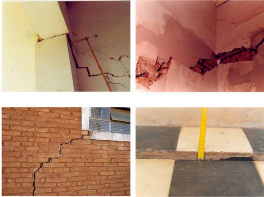
Figura 1: Construções afetadas pelo colapso do solo em Pereira Barreto-SP (RODRIGUES, 2007).
