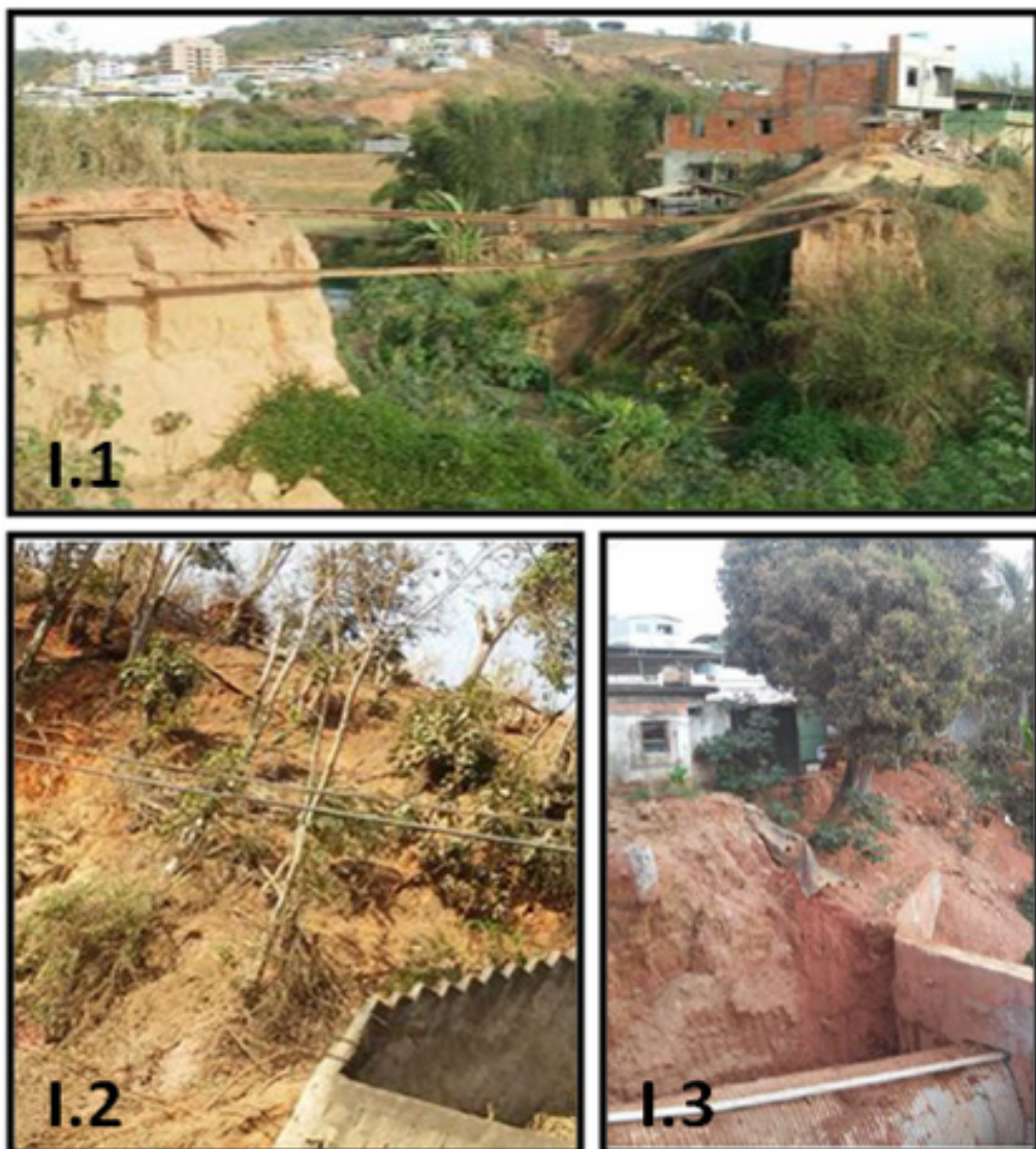
Figura 4. Resumo de registro fotográfico das ocorrências de risco registradas no Bairro Nova Era, à título de exemplo.
