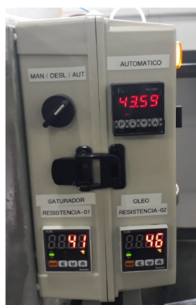
FIGURA 5 . Painel elétrico de comando
