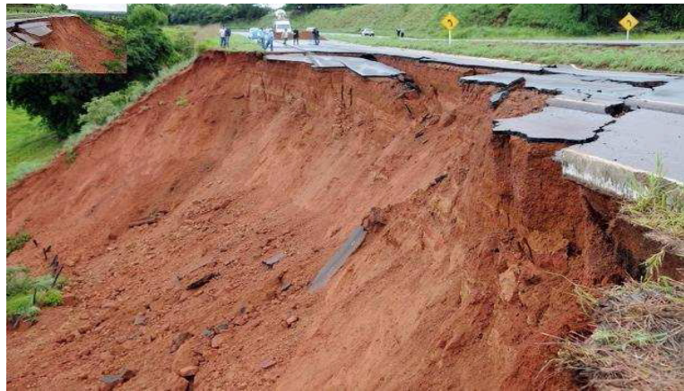
Figura 3. Trecho rompido da BR-060/GO (31/12/2010).
