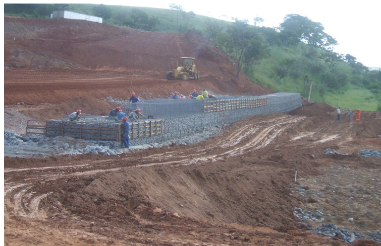
Figura 19. Execução da contenção em gabião.
