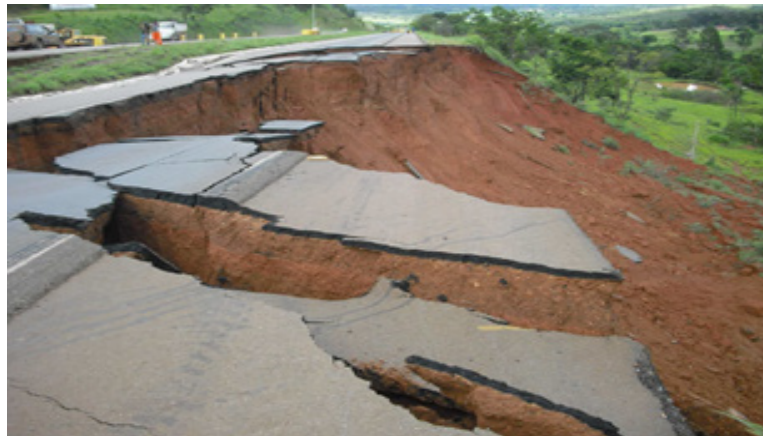
Figura 4. Trecho rompido da BR-060/GO (31/12/2010).
